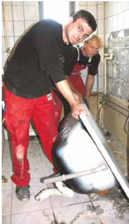
Dominik Sing und Edgar Denecke, Anlagenmechaniker bei der Firma Widmann, tragen eine alte, sperrige Wanne aus dem Badezimmer hinaus. BILD: SCHNEIDER
