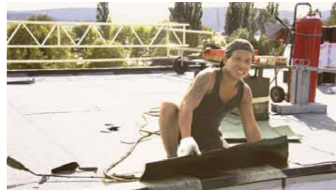
Carlo Karinu und seine Arbeitskollegen von Denz Dach erneuern in Radolfzell die Abdeckung eines Gebäudes. Statt mit Dachziegeln wird auf dem Flachdach mit einem Brenner und Bitumenbahnen gearbeitet. BILD: MELANIE VÖLK
