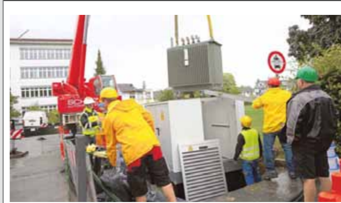
Hier bei der Schillerschule hängt ein rund 20 Jahre alter Trafo am Kran. Er wird durch ein mit neuer Technologie ausgestattetes Modell ersetzt. Die Lebensdauer eines Stromkabels beträgt übrigens rund 50 bis 70 Jahre, die einer modernen Gasleitung, wie sie heutzutage verlegt wird, rund 70 Jahre. BILDER: SABINE TESCHÉ
