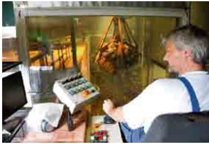
Josef Zimmermann bedient den gewaltigen Greifarm des Krans im Annahmehunker. Rund 30 Wagenladungen à acht Gewichtstonnen werden hier an Werktagen zwischen 7 und 16 Uhr angeliefert. BILDER: SABINE TESCHKE
